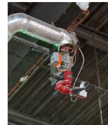
FireRover installé au centre de tri.
