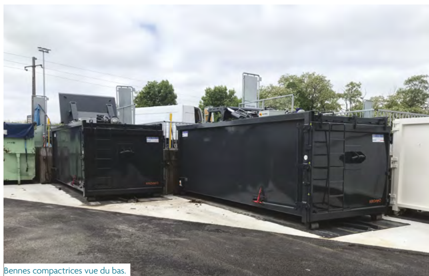
Bennes compactrices vue du bas.
