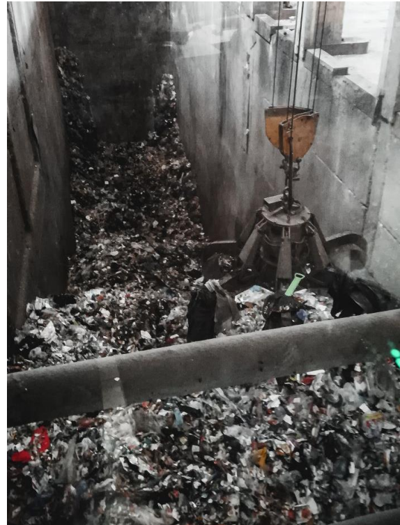
La fosse des ordures ménagères résiduelles de l'Unité de Valorisation Énergétique (UVE). Crédit photo : SYBERT
